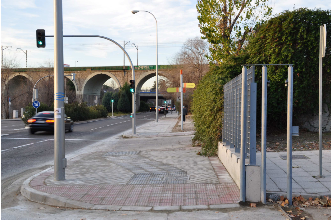
Después de la actuación. Retranqueo de báculo, rebaje de bordillos en pasos de peatones, creación de encaminamientos y mejora de pavimentación en salida del Parque
