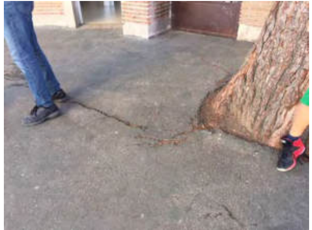
Grietas zona nº6 pino
