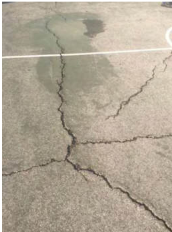
Grietas zona nº2
