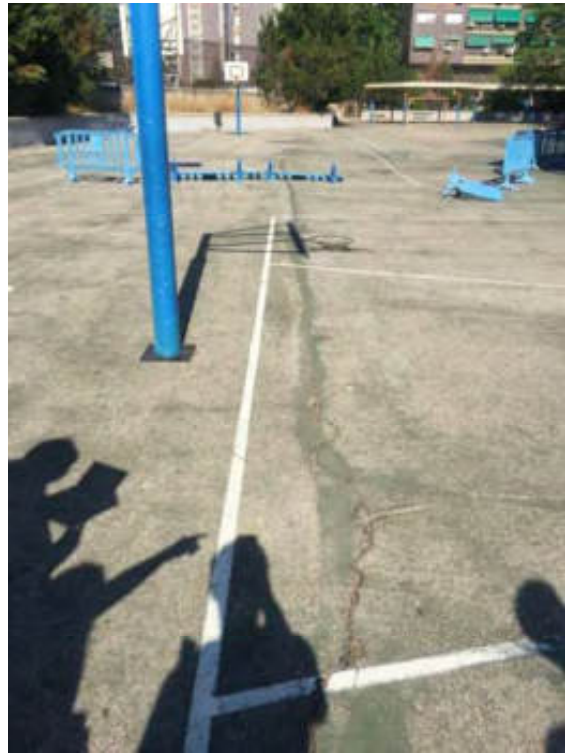
Grietas zona nº3
