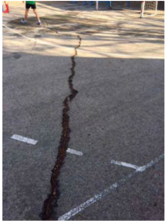
Grietas zona nº1
