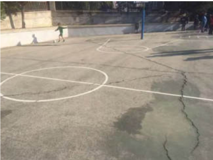
Grietas zona nº2
