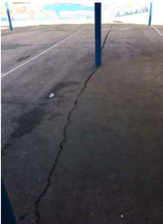
Grietas zona nº3
