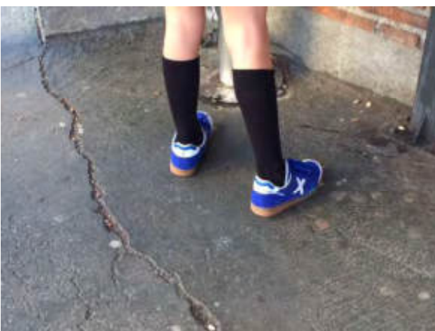
Grietas zona nº6 pino
