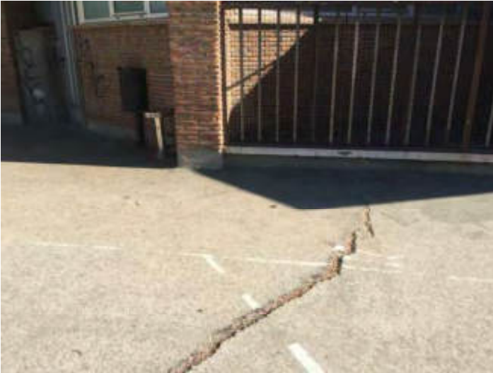
Grietas zona nº1
