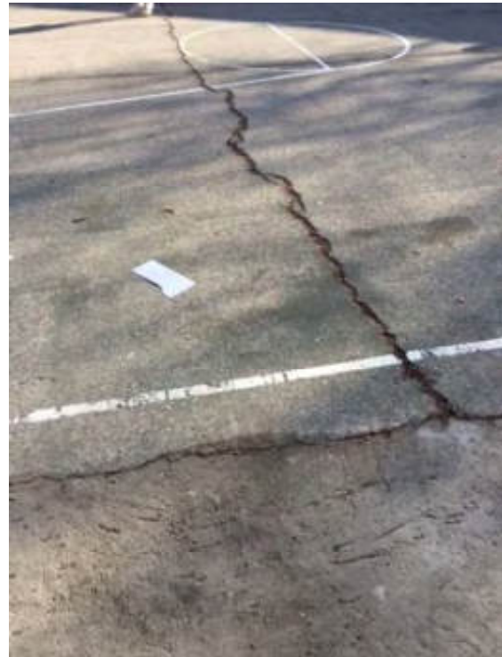
Grietas zona nº4
