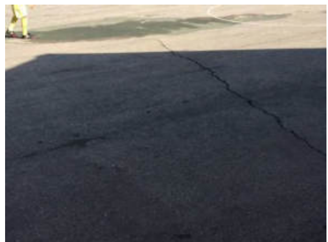
Grietas zona nº7
