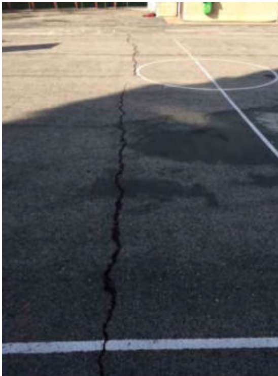
Grietas zona nº4
