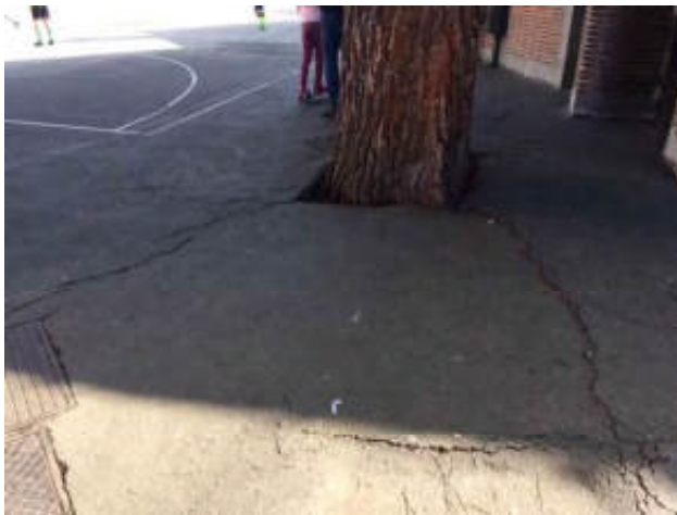
Grietas zona nº6 pino
