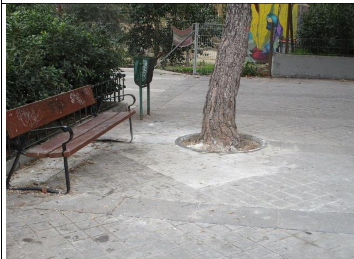
Repaso de pavimento en mal estado
