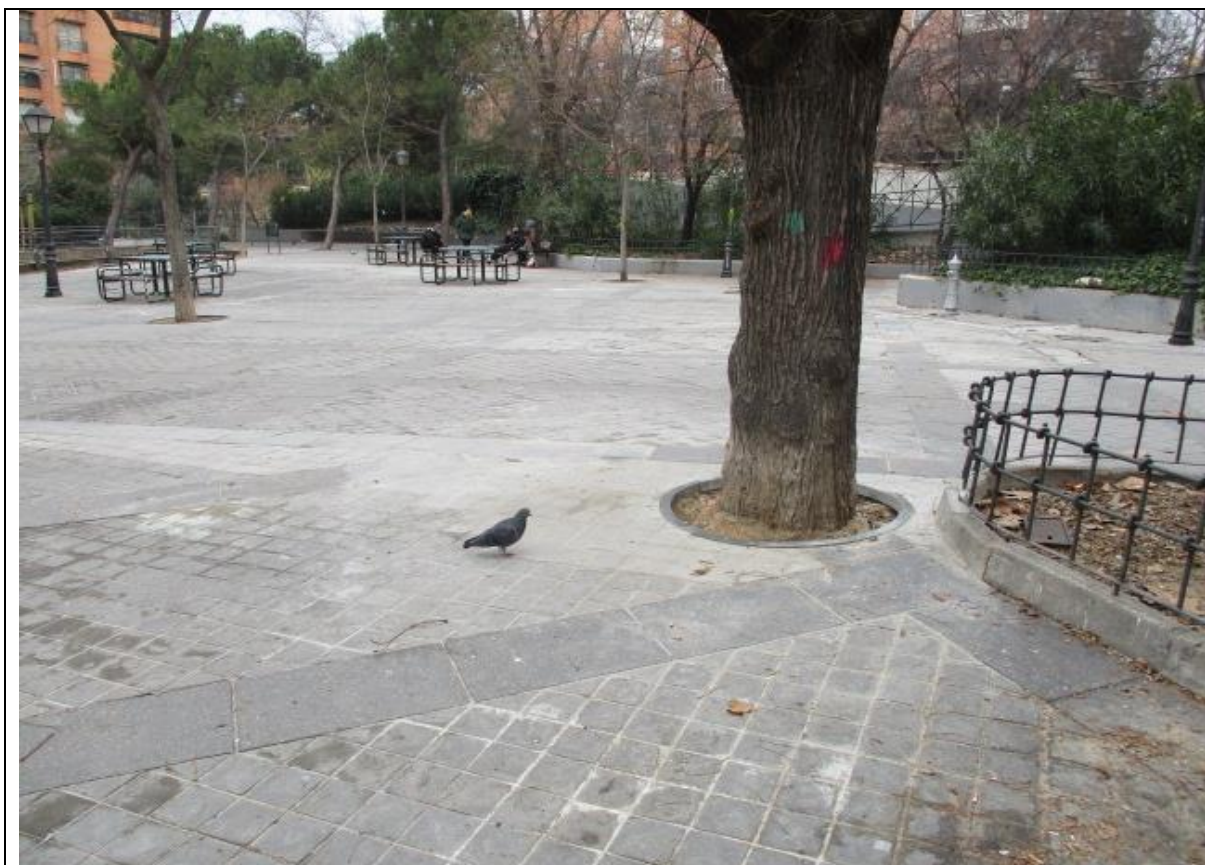
Repaso de pavimento en mal estado
