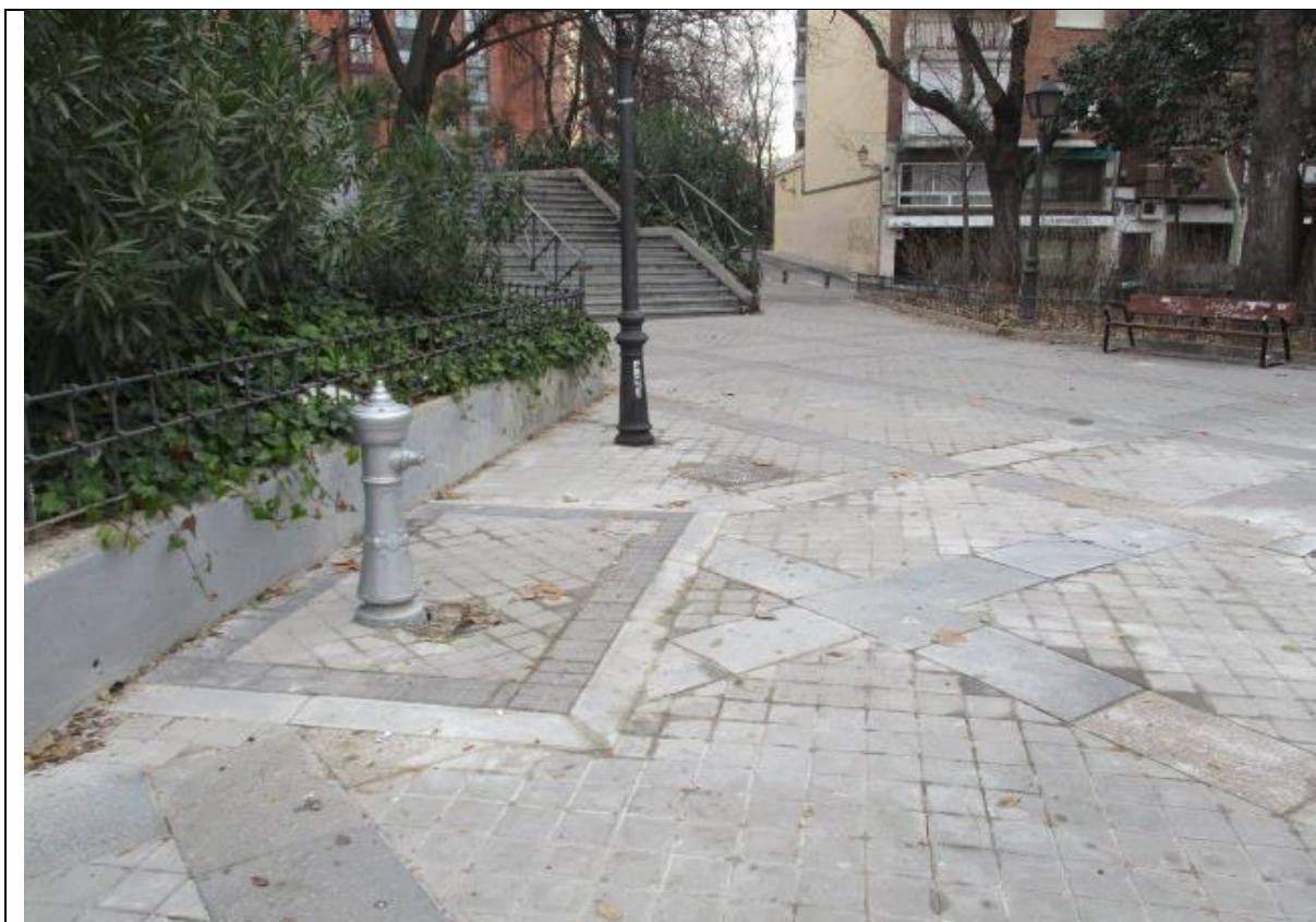
Repaso de pavimento en mal estado
