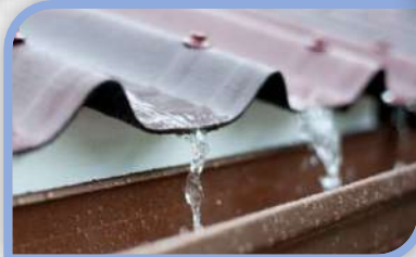
Recogida agua de lluvia
