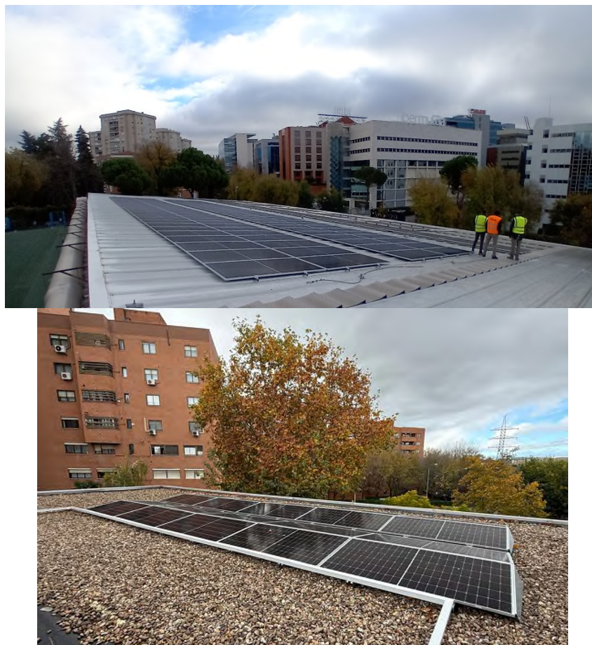
Instalaciones correspondientes a CDM San Juan Bautista y CC Sara Montiel
