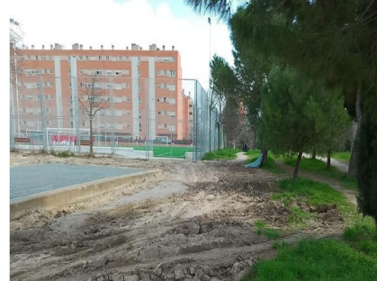
Surcos de maquinaria — riesgo de caídas
