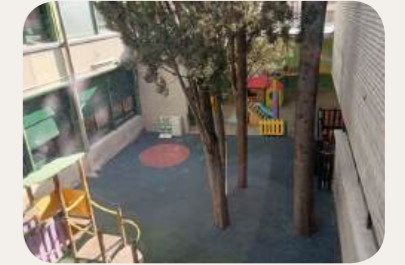
PATIO Falta arena Falta salida directa
