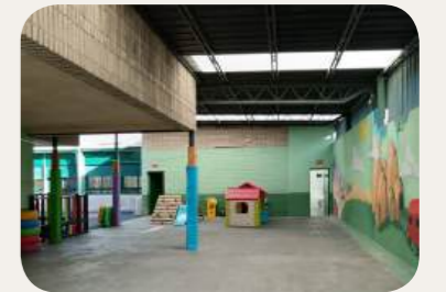
ÁREA BAJO CHAPA Cubrición en mal estado Caluroso en verano Suelo muy caliente en verano Vallado muy alto
