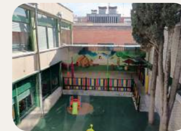
PATIO Falta de arena Falta de acceso/salida directa
